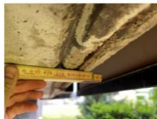
Foto 3: Gjutskarv med rostfärgad avlagring.
